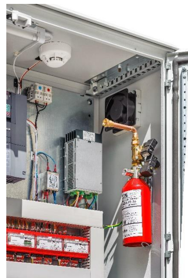
Rys. 12. SUG wewnątrz centrali.
